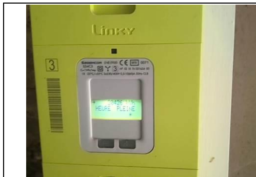
Photo du Compteur électrique
