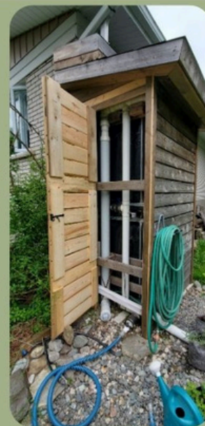
photo J. Cousineau Réservoirs de récupération d'eau de pluie superposés
