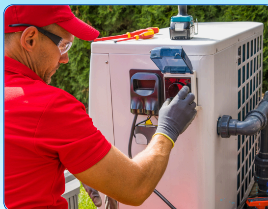
Pompe à chaleur
